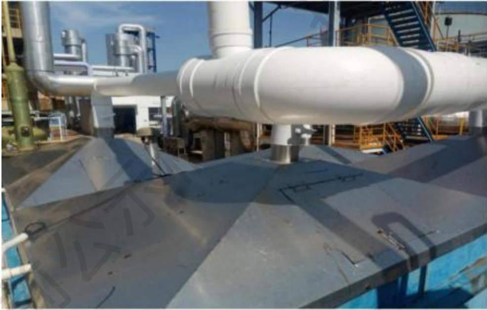
图 3.1-9 现有项目污水处理池加盖收集情况照片
